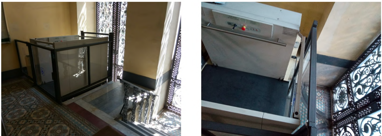
Figura 6 – Imagens da plataforma elevatória para acessar a entrada principal da Uned.
